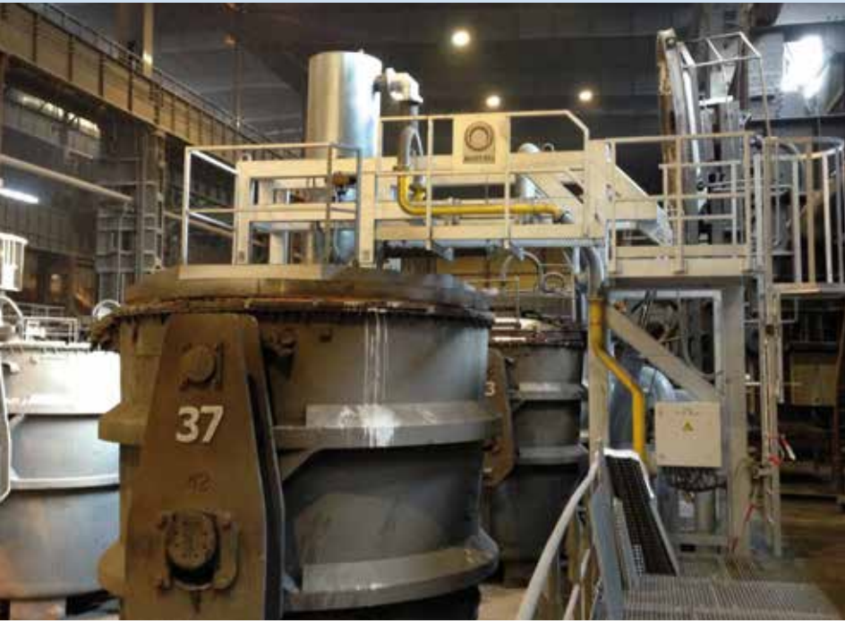
Das neue Pfannenfeuer nutzt das Wärmepotenzial des Abgases zur Brennluftvorwärmung.
