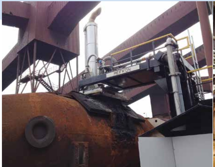
Spart jede Menge Energie: der neue Torpedopfannenaufheizstand.
