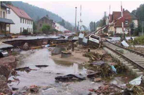
Extremwetterereignisse mit Auswirkung auf die Transportinfrastruktur: die zerstörte Bahnstrecke in Schlottwitz in Sachsen nach dem Jahrhunderthochwasser 2002.
