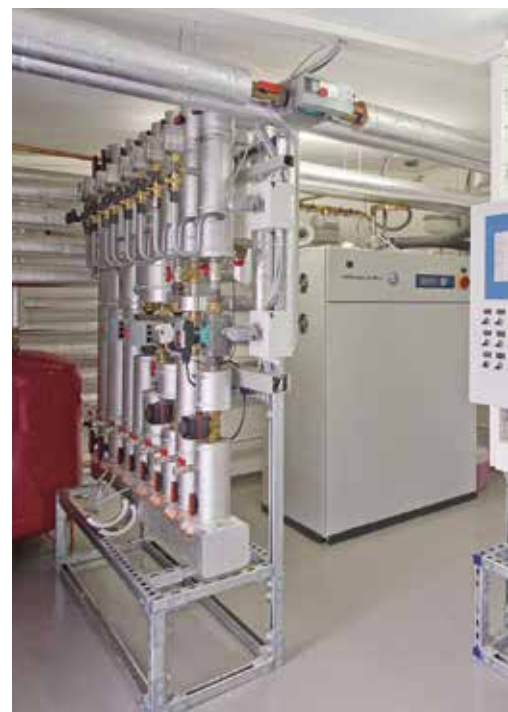
Das EcoBlue 2.0 BHKW im Einsatz – inklusive Pufferspeicher, Regelung und Heizkreisverteilung.
