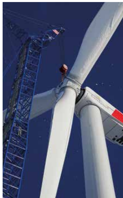
Anlage des Herstellers Nordex, die von der Landwind-Gruppe im Windpark Coppenbrügge im Landkreis Hameln-Pyrmont errichtet wurde.
