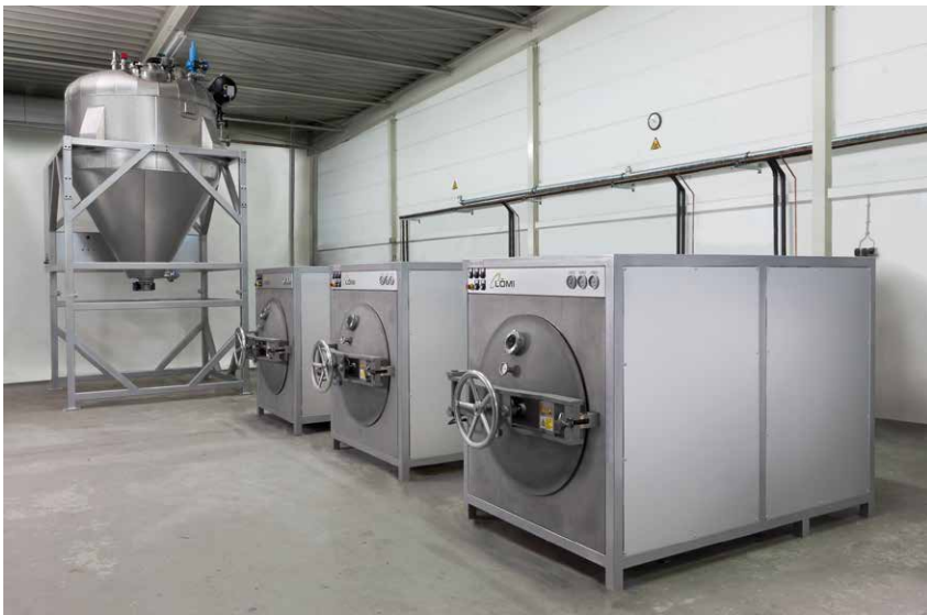
LÖMI 3 Lösemittelentbindungsanlage EBA 900 Lösemittelrückgewinnungsanlage MDA 3000
