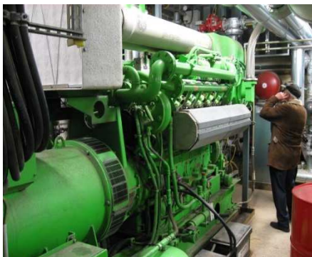
Mit Gas betriebene Motoren zur Stromerzeugung
