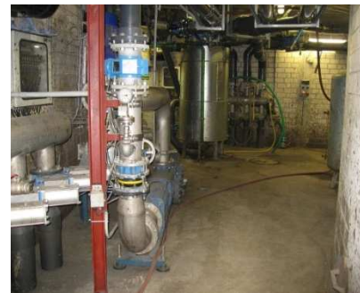
Mess-, Regelungs- und Wärmetechnik
