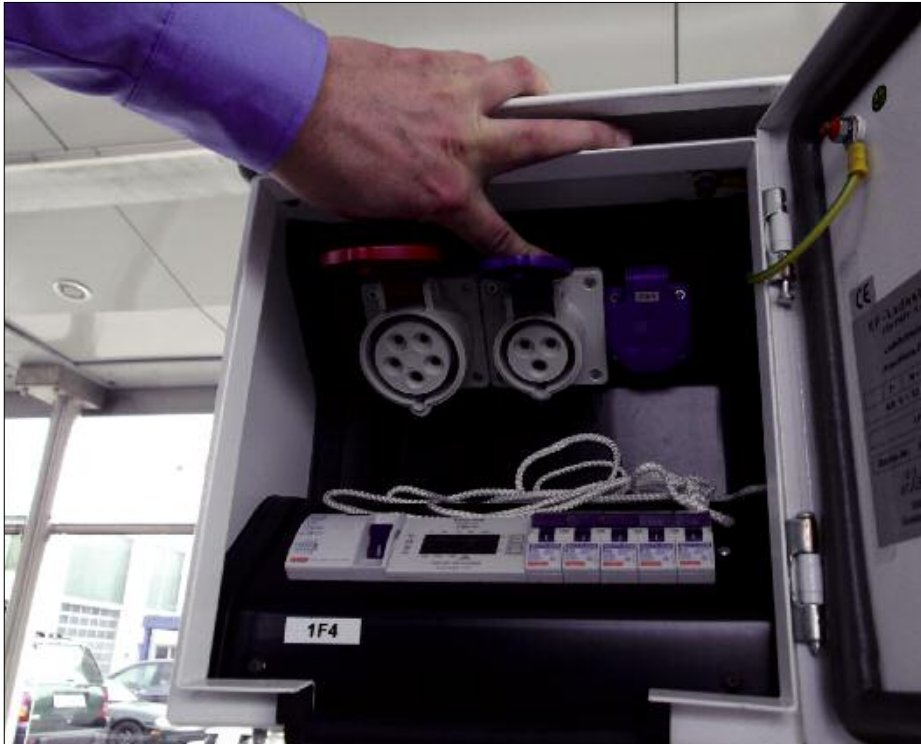
Blick in das Innere der Ladestation mit Dreh- und Wechselstrom. Foto: Hering
