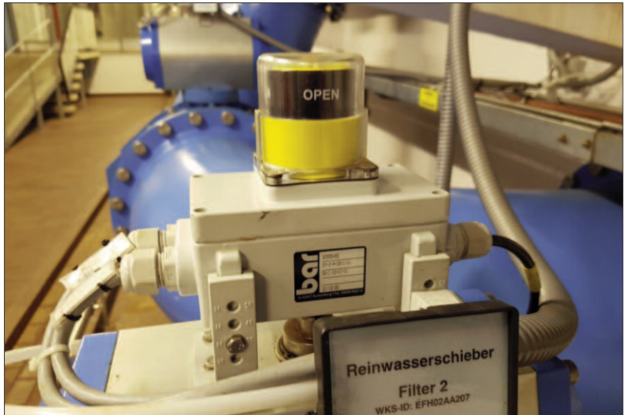
Anlagenkennzeichnung einer Reinwasserarmatur im Wasserwerkskennzeichnungssystem WKS. Fotos (2): enercity
