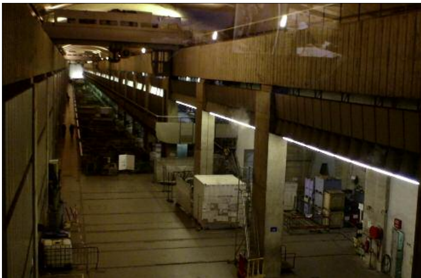
Blick ins Innere des Gezeitenkraftwerks an der Flussmündung der Rance. Foto: Kreher
