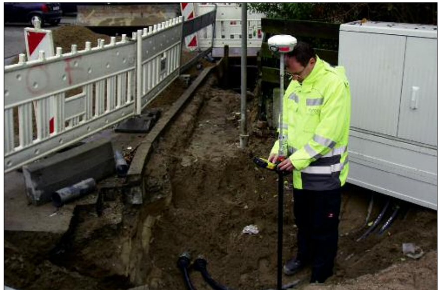
Während der Bauphase wird am offenen Graben vermessen, um Kenntnis von der Lage der verlegten Rohre und Leitungen zu erhalten. Foto: enercity
