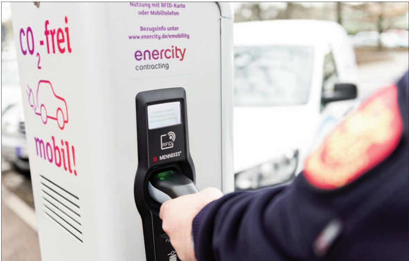
Ladestation von enercity für Stromer auf einem Parkplatz in Hannover.
