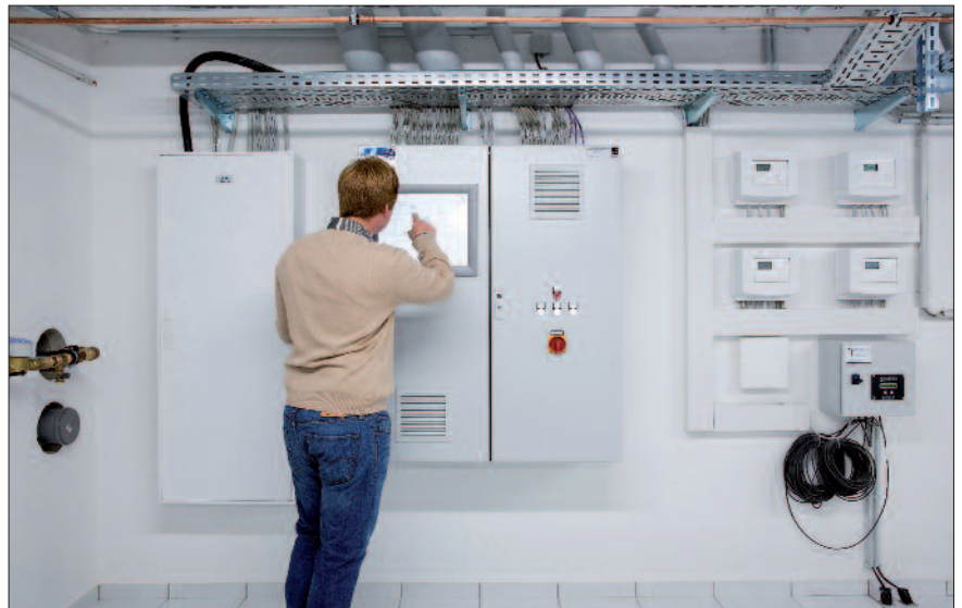
Die Zentrale der Gebäudeleittechnik mit Schaltschrank und Wärmepumpenreglern mit Monitor zur Visualisierung der Heiztechnik. Bild: Stiebel Eltron
