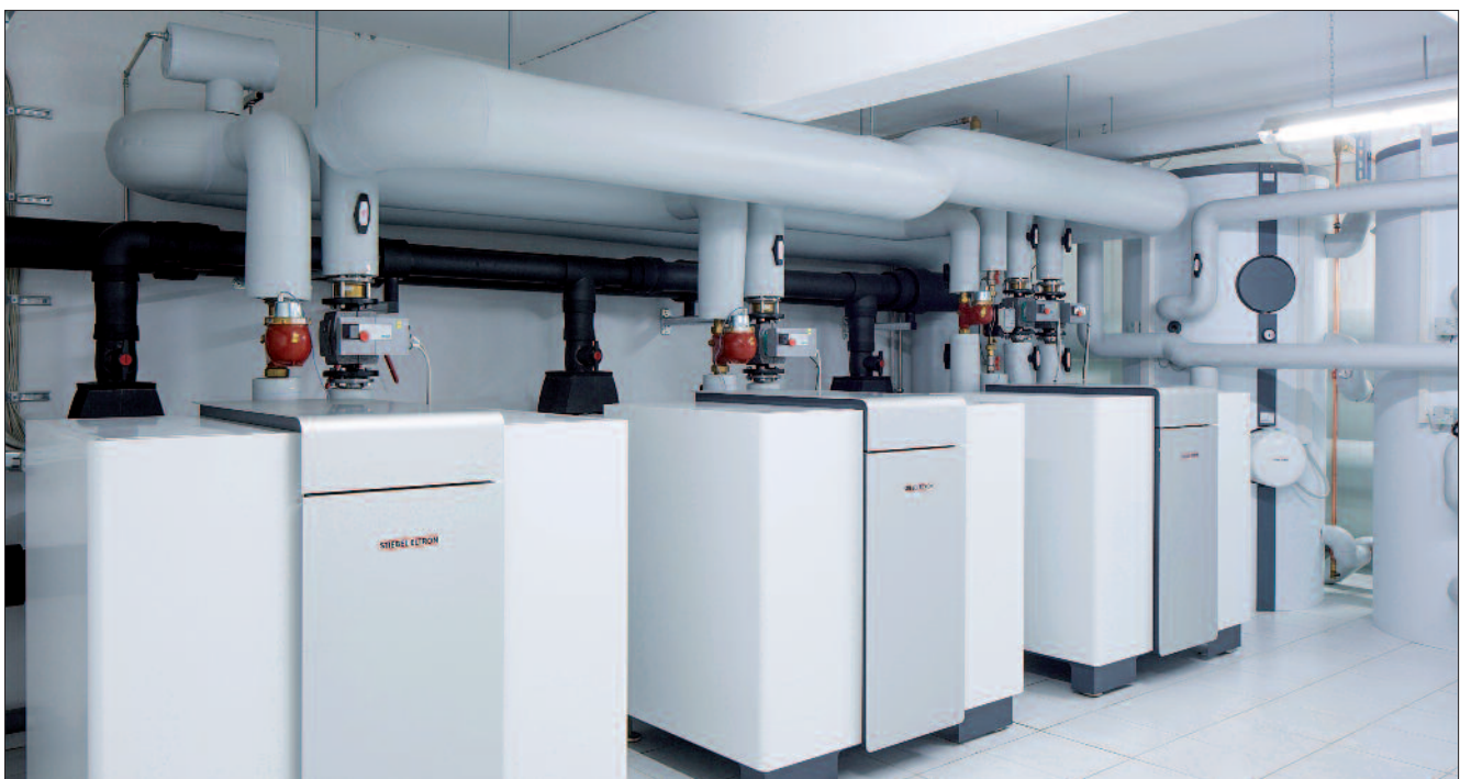
Drei Wärmepumpen. Rechts davon befinden sich zwei Pufferspeicher à 1500 Liter.
