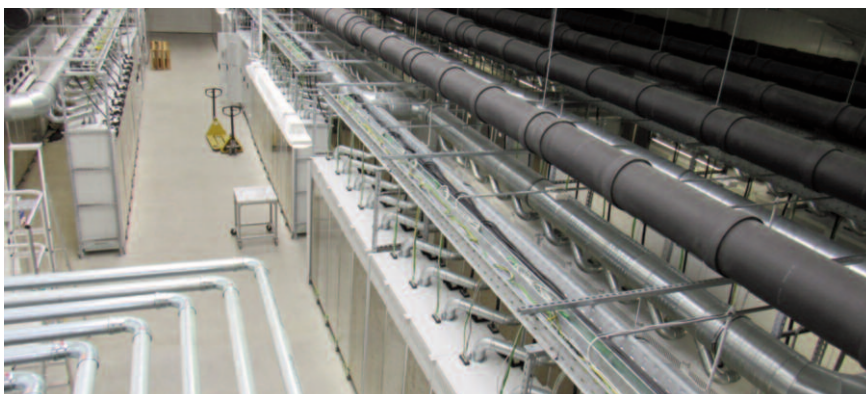
Halle mit Klimatechnik und Modulschränken der Batterieanlage.
