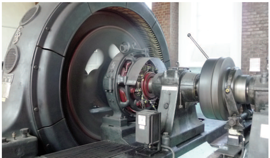
Der Generator stammt aus dem Jahr 1921.
