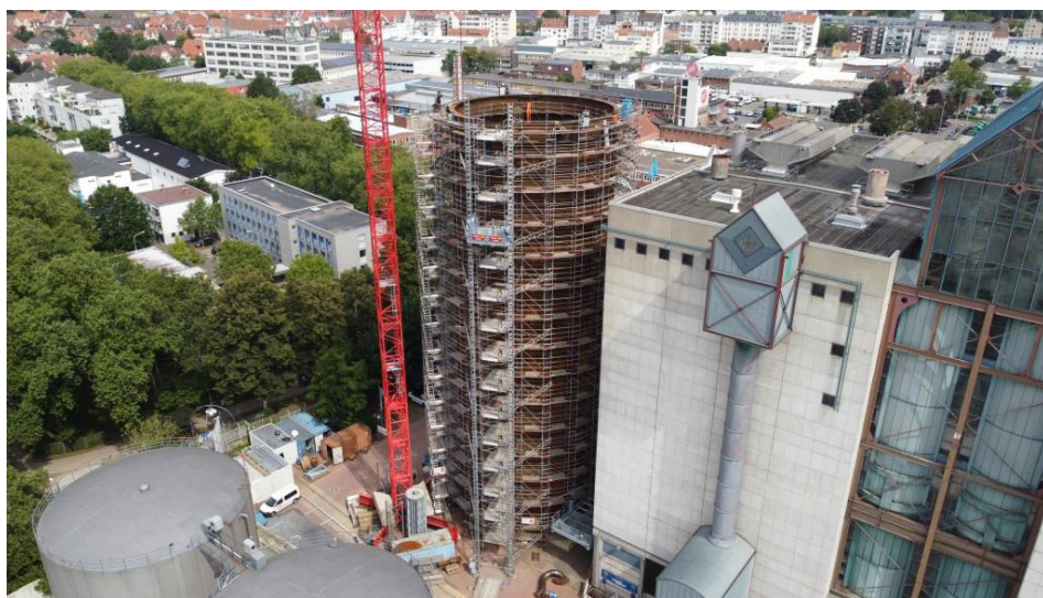
GAMOR der Energie SaarLorLux – Wärmespeicher
