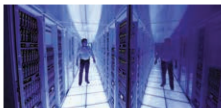
SAP Data-Center; Foto: SAP
