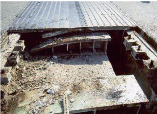
alt: Übergang marode, nicht wasserdicht
