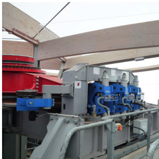
Unverzichtbar: Die Sicherheitsbremsen setzen bei Gefahr die Anlage zuverlässig still.
